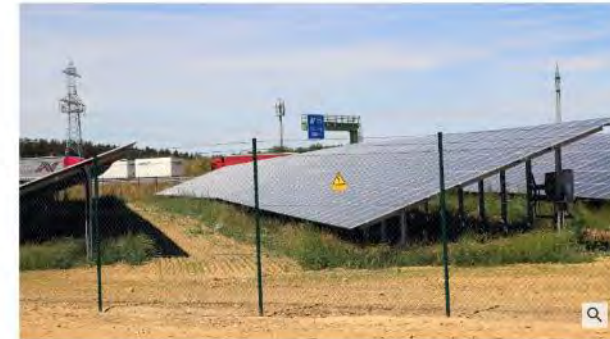
Eine Freiflächenphotovoltaikanlage entlang der Autobahn A 96 auf Höhe des Glichinger Ortsteils Geisenbrunn. Der Bund will den Bau solcher Installationen beschleunigen. (Foto: Franz Xaver Fuchs)
